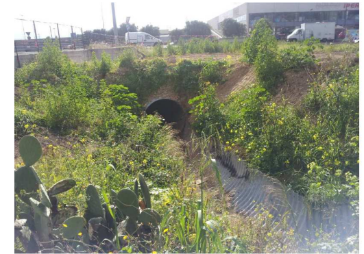
Figura 19: opere di presa superficiali
